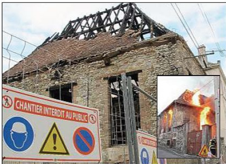
La municipalité envisageait de conserver et de valoriser l'ancienne filature de soie du tènement Boissieux, dans le cadre de ses projets d'aménagement du quartier de la place Prunelle. Une idée mise entre parenthèses par l'incendie de dimanche. Aujourd'hui, les élus espèrent pouvoir reconstruire, tout étant question de "possibilités".
